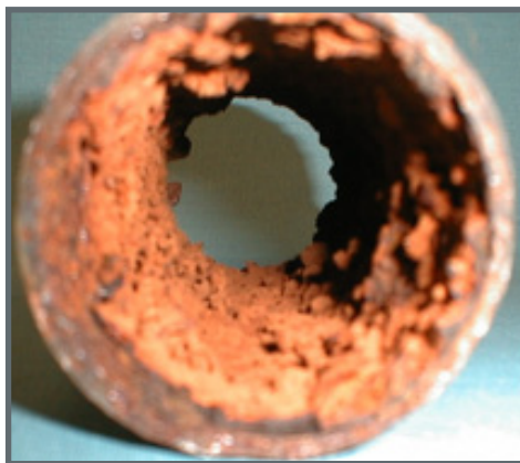
Fig. 18 – Corrosión en un circuito cerrado
