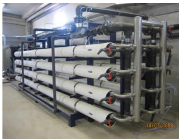
Fig. 43 – Plantas de ósmosis inversa PERMAQ ECO, PERMAQ PRO Y EXA RO
